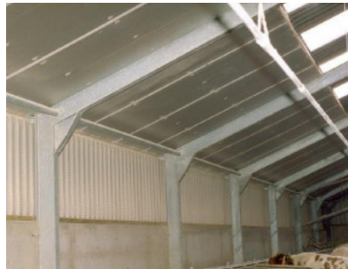
Dakisolatie uitgevoerd met kunststofschuim isolatieplaten (PUR) afgewerkt met een aluminium folie.
