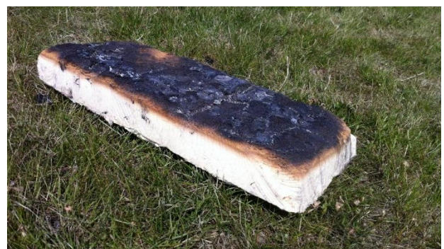
Een PIR FM approval die is gecarboniseerd als gevolg van een naburige brand (>50 KW/m 2 straling).
