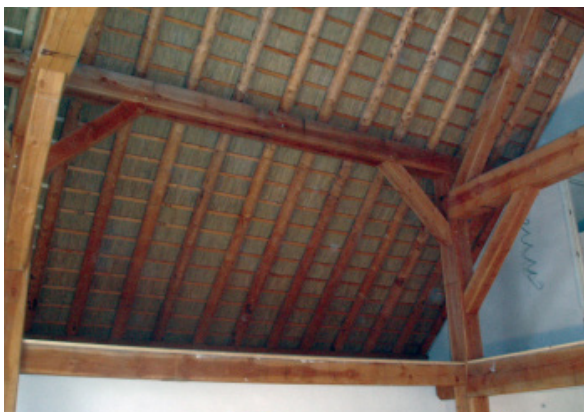
Aan de binnenkant van dit dak is riet gebruikt om te isoleren. Riet kent een goede isolerende werking, maar is wel zeer brandbaar.
